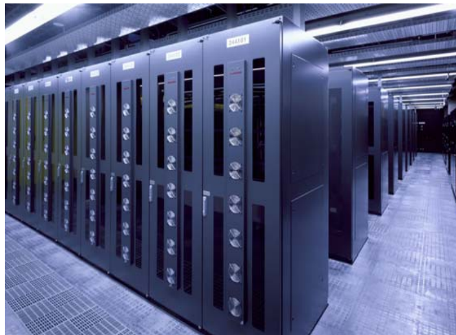
第二データセンター
