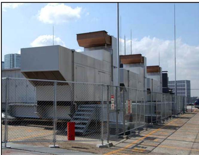
非常用発電機
