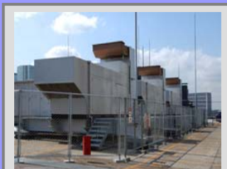
非常用発電機
